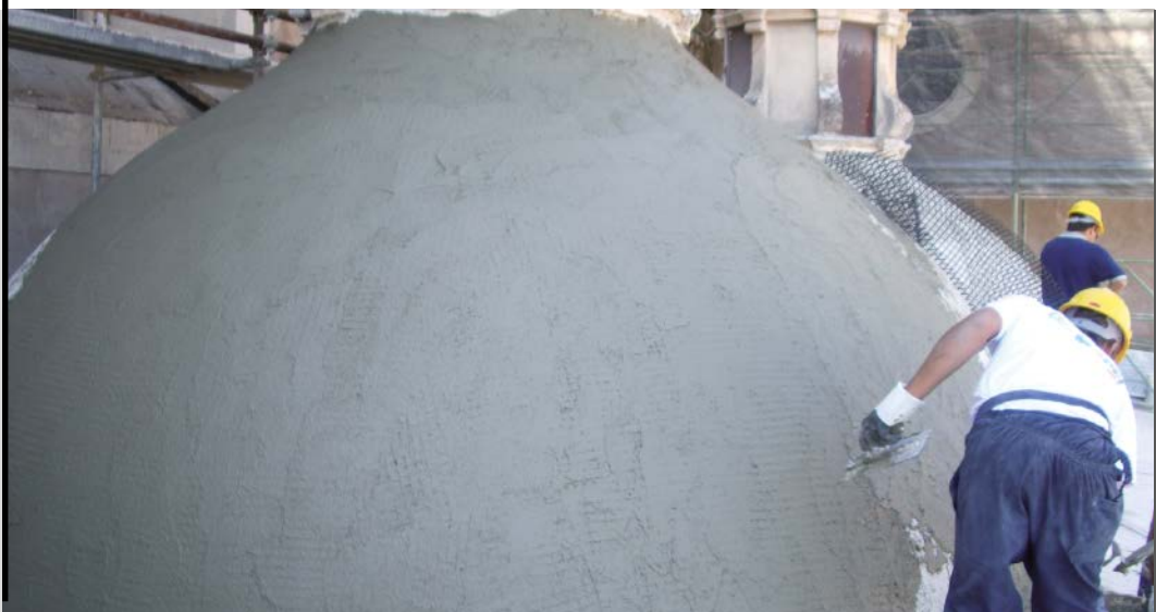
Foto 5 Reforzamiento de una estructura de concreto con PLANITOP HDM + MAPEGRID G220 , Mortero no estructural clase R2
