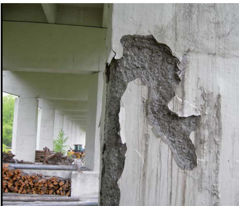
Foto 1 Ejemplo de concreto deteriorado por agresión de sulfatos.
